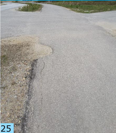
Väylän reunasta puuttuu asfaltti Kullanhuuhtojantien varrella.
