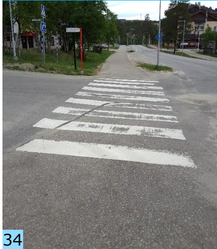
Suojatien reunatuki puuttuu Revontulentiellä.
