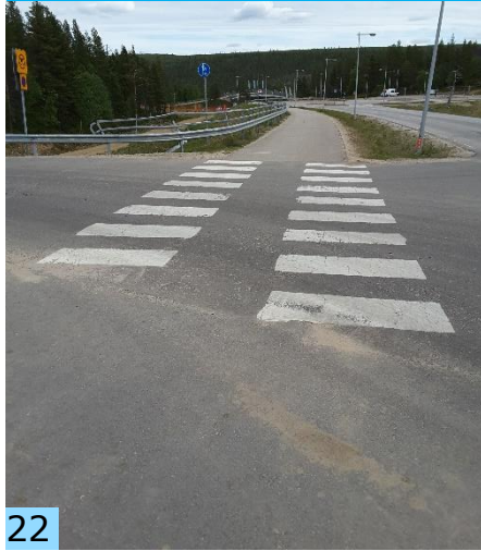
Suojatien reunatuki puuttuu Vaeltajantiellä.
