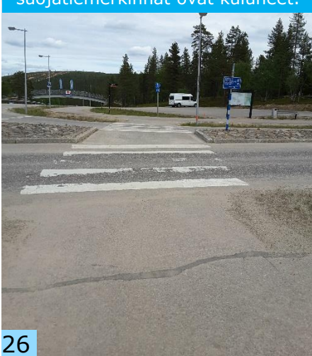
Suojatien reunatuki puuttuu Saariseläntiellä, suojatiemerkinnyt ovat kuluneet.
