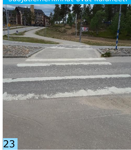
Suojatien reunatuki puuttuu Saariseläntiellä, suojatiemerkinnyt ovat kuluneet.
