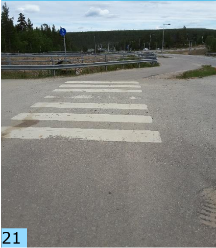
Suojatien reunatuki puuttuu Alarinteentiellä.
