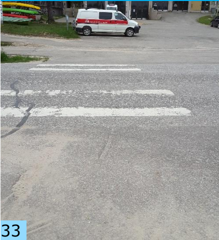
Suojatien reunatuki puuttuu Saariseläntiellä, suojatiemerkinnot ovat kuluneet.
