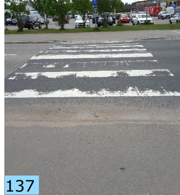
Suojatien reunatuki puuttuu Petsamontiellä.
