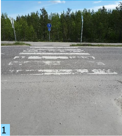
Suojatiemerkinnot kuluneet Inarijärventiellä.
