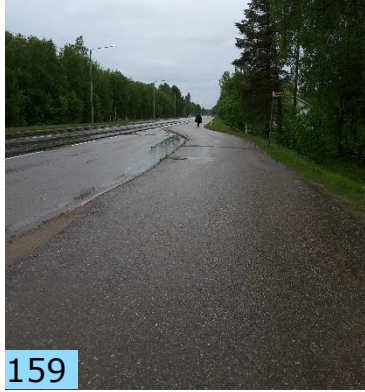
Pysäkki jalankulun väylällä Ivalontien varrella, routavaurio.
