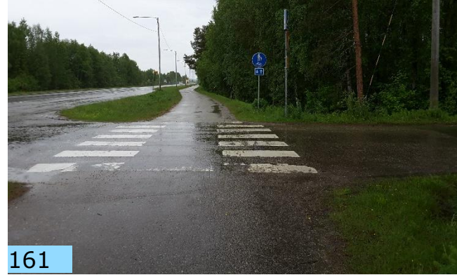
Suojatien reunatuki puuttuu Näverniementielle.
