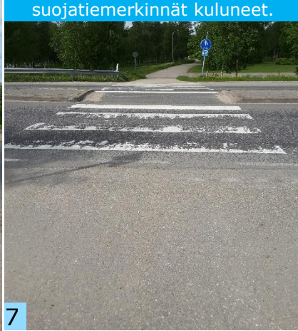
Suojatiellä ei reunatukia reunoilla tai keskellä Inarijärventiellä, suojatiemerkinnot kuluneet.
