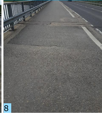
Väylän ja ajoradan välistä puuttuu reunatuki Inarijärventien varressa.
