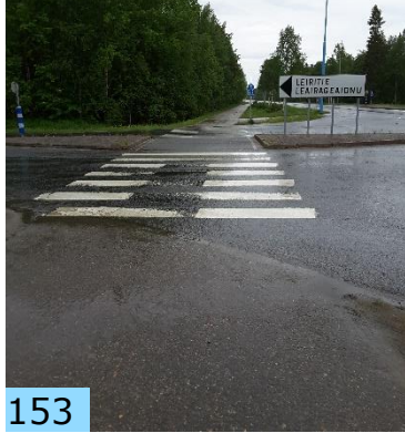
Suojatien reunatuki puuttuu Leiritiellä, merkinnät kuluneet.
