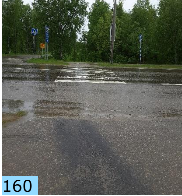
Suojatien reunatuki puuttuu Ivalontielle, merkinnät kuluneet.
