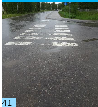
Suojatien reunatuki puuttuu Rantatiellä, merkinnät kuluneet.
