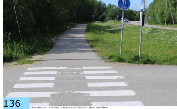
Suojatien reunatuki puuttuu Pikkupatunantiellä.
