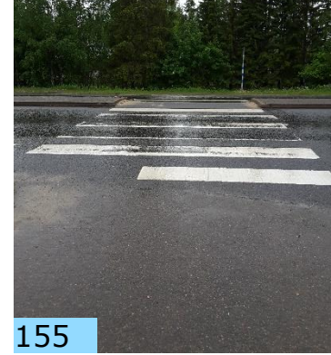
Suojatien reunatuki puuttuu Ivalontielle, merkinnät kuluneet.
