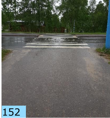
Suojatien reunatuki puuttuu Ivalontielle, merkinnät kuluneet.
