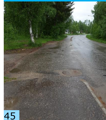
Reunakivi puuttuu väylän reunoista Rantatien varrella.
