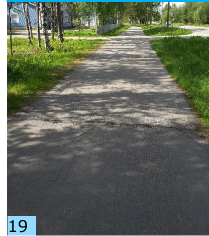
Routavaurioita väylällä Koppelontien varrella.
