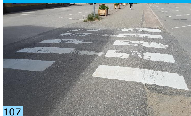
Suojatien reunatuki puuttuu Ivalontien varrella, merkinnät ovat kuluneet.
