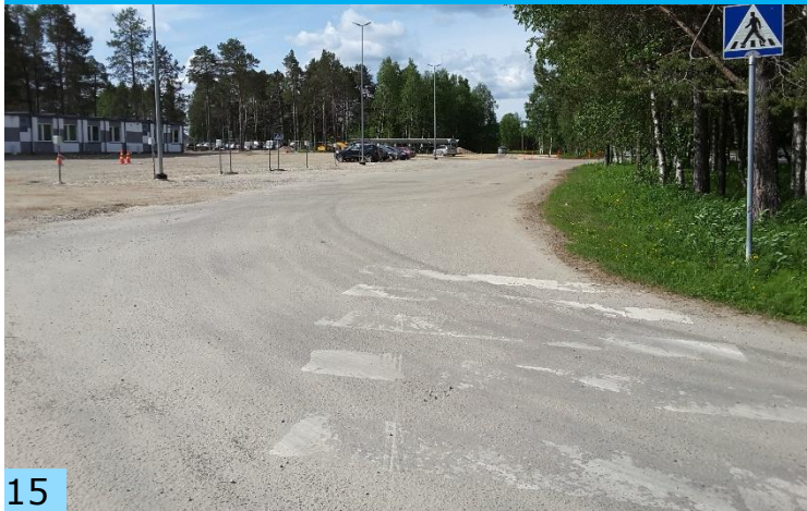
Suojatiellä ei ole reunatukea, suojatiemerkinnyt ovat kuluneet.
