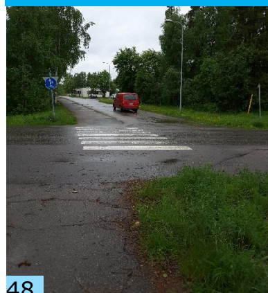
Suojatien reunatuki puuttuu Rantatiellä.
