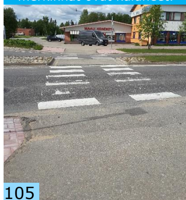
Suojatien reunatuki puuttuu Ivalonttiellä, merkinnät ovat kuluneet.
