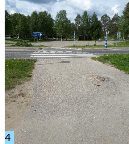
Suojatiellä ei reunatukia Inarijärventiellä, suojatiemerkinnot kuluneet.
