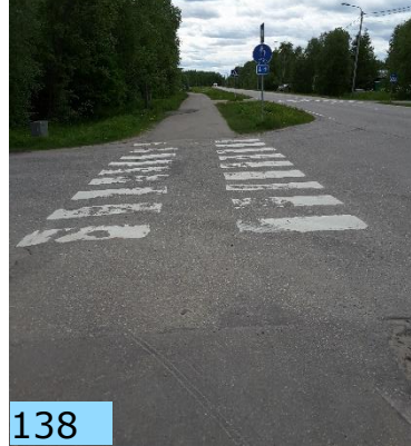
Suojatien reunatuki puuttuu Mukkavuopajantiellä.
