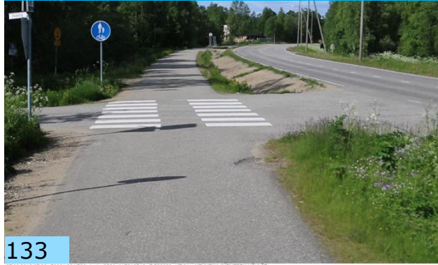
Suojatien reunatuki puuttuu Ilvestiellä.
