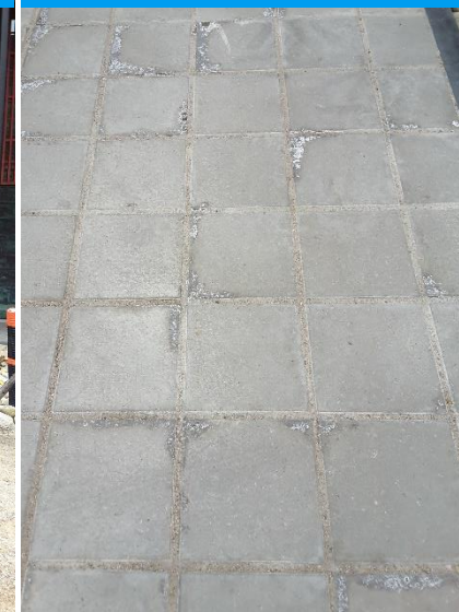
Laatoituksessa isot raot.
