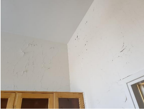
Kuva 1. Tilasta 225, jossa seinä- ja kattopinnoilla pinnoite irronnut.
