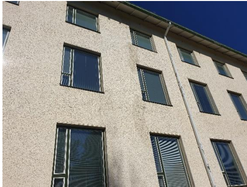
Kuva 4. Julkisivusta, jossa nähtävissä kerrosten välissä ikkunoiden reunojen kohdilla värimuutosta.
