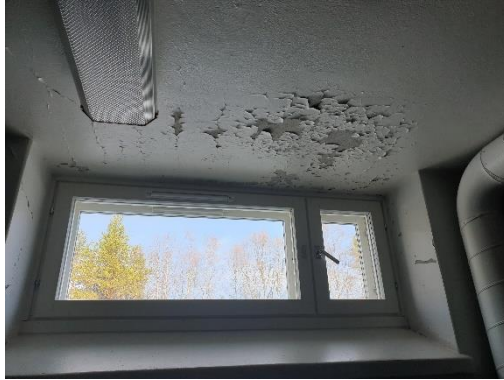
Kuva 2. Tilasta 013, jossa sisäkaton pinnoite irtoillut.
