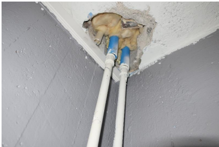
Kuva 46, porrashuoneen (B130) alimman välitasanteen alla putkiläpivienti, jossa avoin villa. Putket nousevat kotelossa ylöspäin porrashuoneen kohdalla
