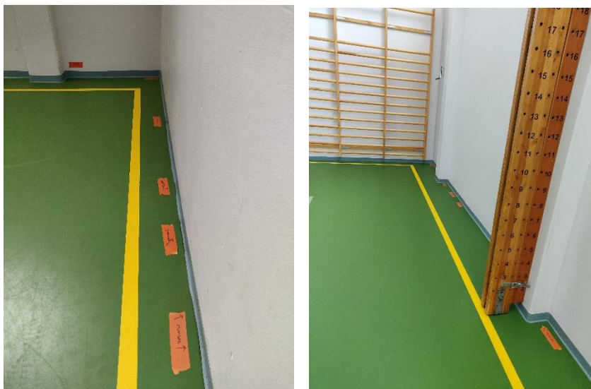
Kuvat 15 ja 16, liikuntasali, heikkoo, kohtalaista ja runsasta vuotoa lattiarajassa
