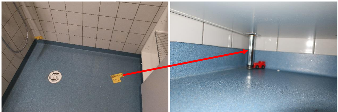
Kuvat 19 ja 20, tilassa B104 kohtalaista vuotoa lattiamaton ylösnoston ja laatoituksen liitoskohdassa molemmissa nurkissa. Oikeanpuoleisessa kuvassa kiintokalusteen alta kuvattuna toinen nurkkaus, johon keskellä lattiaa olevalla teippauksella viitataan. Myös tilan B103 (Kuraet.) nurkissa havaittiin vastaavanlaisia vuotokohtia maton ylösnostolta
