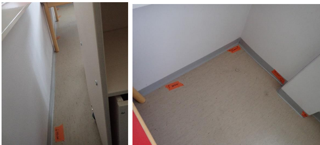
Kuvat 13 ja 14, tila 153, ulkoseinälinjalla lattialistan reunalta heikkoo, kohtalaista ja runsasta vuotoa, pistemäisenä koko seinälinjan matkalla
