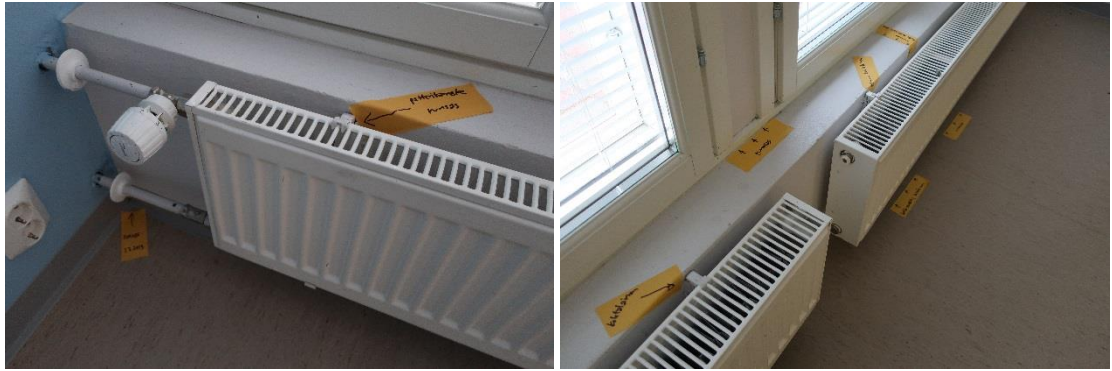
Kuvat 17 ja 18, tilojen B112 ja B106 patterikannakkeilla poikkeuksellisen paljon vuotokohtia. Lisäksi vuotoja lattia-ulkoseinäliittymässä sekä mm. ikkunapenkissä olevalta halkeamalta
