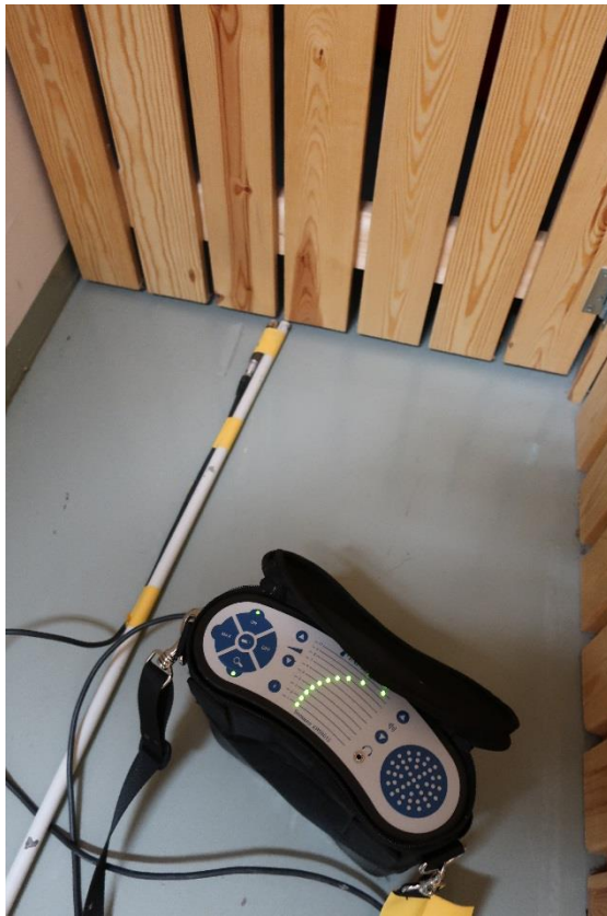
Kuva 26, tilassa B119 ei päästy mittaamaan ulkoseinän vierustaa, koska häkkivarasto lukittuna. Havaittiin kuitenkin, että kaasua kulkeutuu kauaskin ulkoseinältä. Todennäköisesti vuoto tulee lattiarajasta kuten viereisessä kuivaushuoneessa B120
