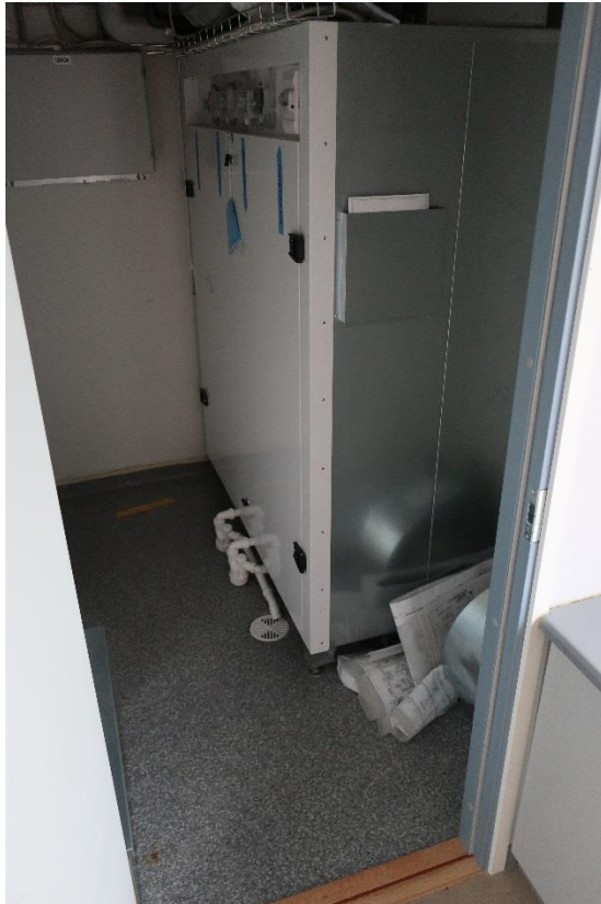
Kuva 22, molempien päiväkotien IV-konehuoneissa havaittiin vuotoja lattiarajassa; siis myös IV-koneen takaa, jonka tiivistyskorjaaminen edellyttäisi IV-koneen poistoa
