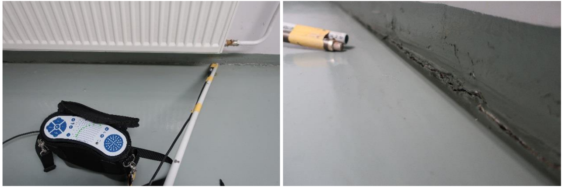
Kuvat 24 ja 25, tilassa B120 (Kuivaus) poikkeuksellisen laajasti runsaita vuotoja ulkoseinän ja lattian rajapinnasta. Lattiaraja haljennut kuten oikeanpuoleisessa kuvassa näkyy
