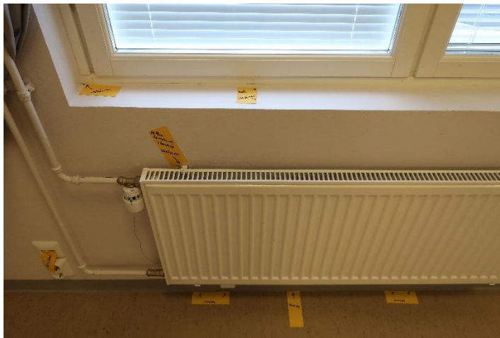
Kuva 36, tilassa B137 ikkunan kohdalla vuotoja lattiarajassa, sähkörsialla, patterikannakkeella sekä ikkunan alaosassa
