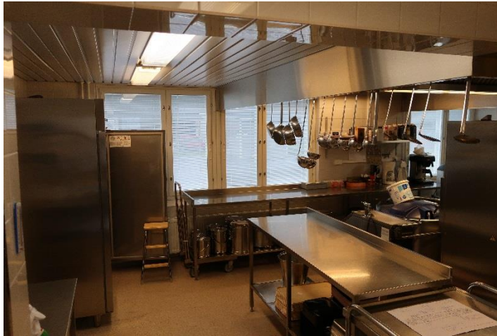
Kuva 27, keittiötiloissa on akryylibetonilattia, joka on rakenteena todella tiivis. Vuotoja ei havaittu lattiarajasta kuin yksi kohtalainen, muutoin kaikki vuodot sijoittuivat ikkunarakenteille, joissa havaittiin pääasiassa vähäisiä vuotoja karmirakenteen ja seinärungon liittymäkohdista
