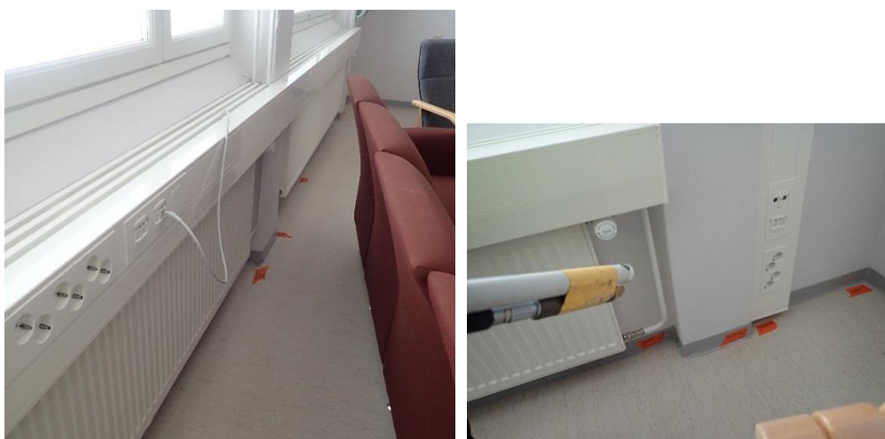
Kuvat 11 ja 12, tila 160 (opettajien huone), ulkoseinälinjalla lattialistan reunalta kohtalaista ja runsasta vuotoa
