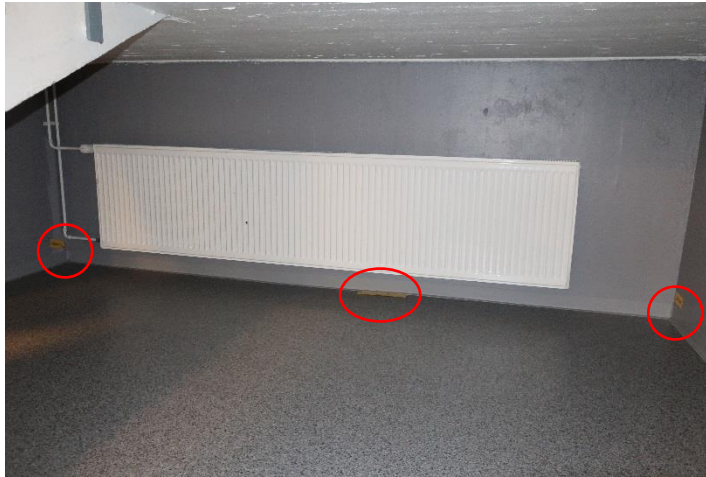
Kuva 31, tila B130 (porrashuone), vuotohavaintoja lattiarajassa
