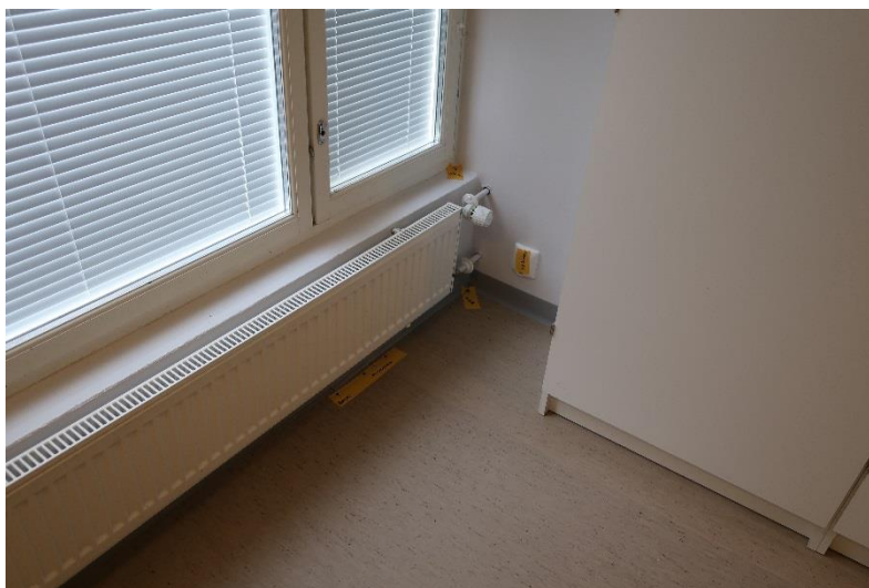
Kuva 40, myös tilassa B132 tyypillisiä vuotoja lattiarajasta, sähkörasialta sekä ikkunan alaosa
