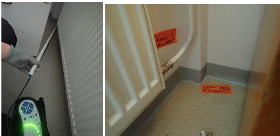
Kuvat 7 ja 8, tila 155, ulkoseinällä runsasta ja kohtalaista vuotoa pilareiden nurkilla
