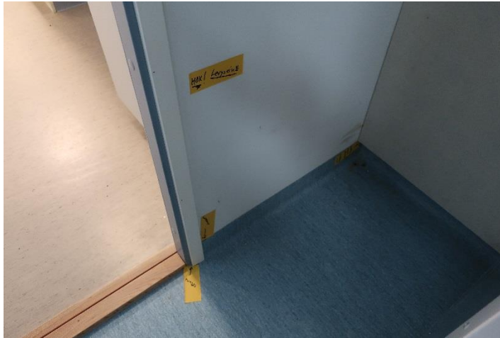
Kuva 35, tilojen B133/B134 levyrakenteisen väliseinän kohdalla vuotoa jopa välioven kynnyksellä saakka; kaasua kulkeutuu väliseinän sisällä/alaosassa. Myös tässä IV-konehuoneessa vuotoa IV-koneen takaa
