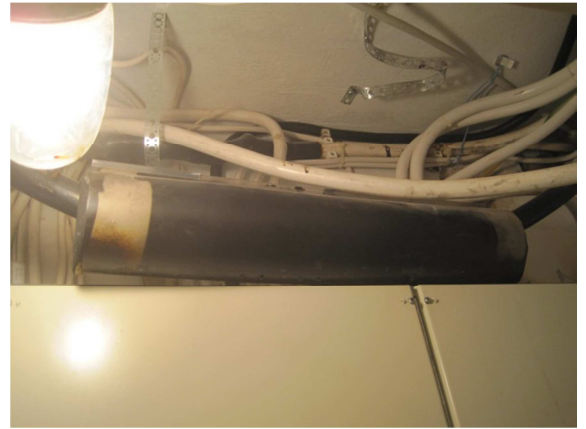
Kuva 2. Päärakennuksen sähköpääkeskuksen vanhat "pikiki"kaapeloinnit on pohjakerroksessa havaitun pikimäisen hajun todennäköinen lähde.
