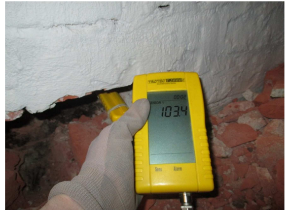
Kuva 10. RA3 ja RA4, rakenteen kosteus on koholla.
