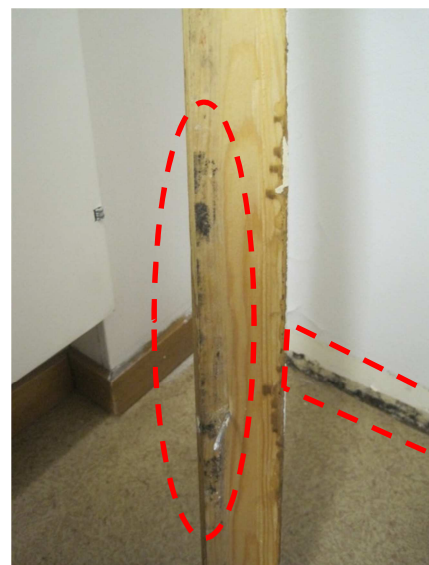
Kuva 28. Asuntola 2:n ryömintätilan yläpuolisen asunnon keittokomeron väliseinän alaosassa ja jalkalistan takana havaittiin mikrobikasvustoa (M14 ja M15)
