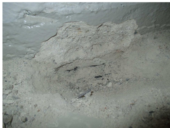
Kuva 15. RA7, raudoite ja bitumisively esillä
