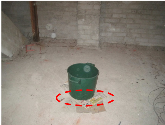
Kuva 43. RA32, tila 336. Rakenneavaus suoritettiin alalle, joka oli ollut toistuvasti alttiina kattovesivuodolle.
