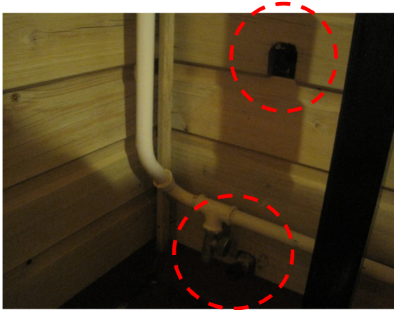
Kuva 1. Päärakennuksen löylyhuoneessa havaittiin voimakasta pikimäistä hajua paneloinnin läpivientien kautta.
