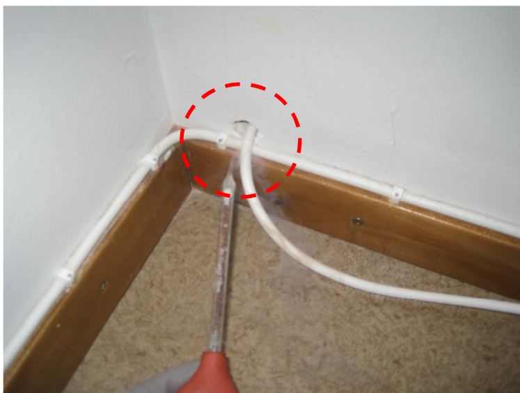
Kuva 27. Asuntola 2:n ryömintätilan yläpuolisen asunnon jälkiasennettu johtoläpivienti havaittiin erittäin epätiiviiksi.
