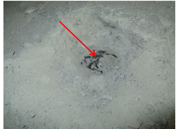
Kuva 7. RA2, Pinta- ja pohjalaatan välissä on bitumieriste.
