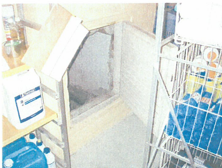
Kanaaliin pääsee myös oppilaitoksen puoleisesta päästä => kanaalin hajuilla esteetön pääsy oppilaitoksen puolelle hataran oven kautta.
