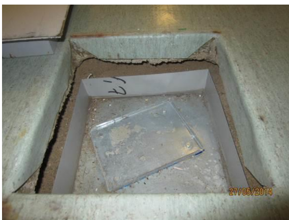
Kuva 12. Päärakennuksen käytävän alapohjaa. IV-tarkastusluukun kohdalla alapohjassa ei ole havaittavissa lämmöneristettä.
