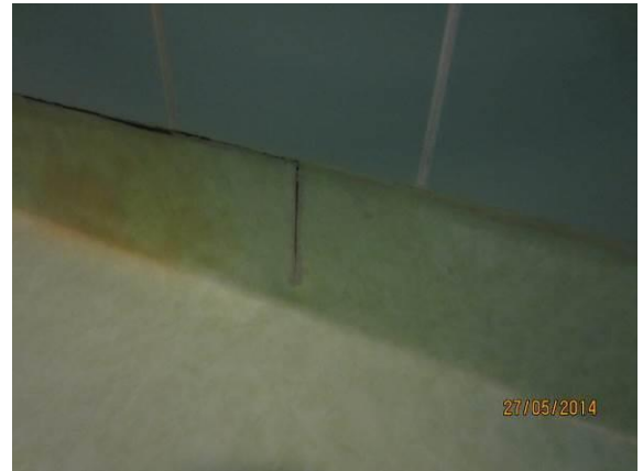
Kuva 34. Kellarin pukuhuoneen suihkunurkassa muovimatto on rikki.
