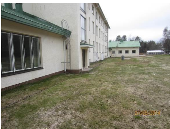
Kuva 8. Betonikourujen asennuksissa on puutteita.
