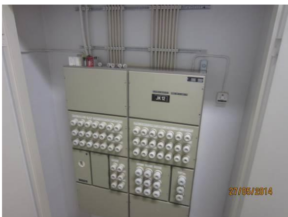
Kuva 58. JK12 Keittiötilojen käytävällä. Keskus on tyyppikilven perusteella vuodelta 1976.
