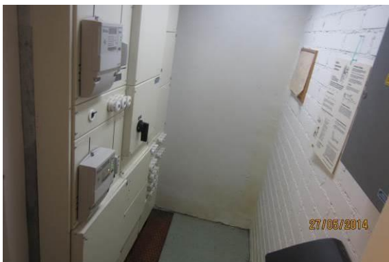
Kuva 56. Pääkeskus -ja mittarikeskus kellarissa.
