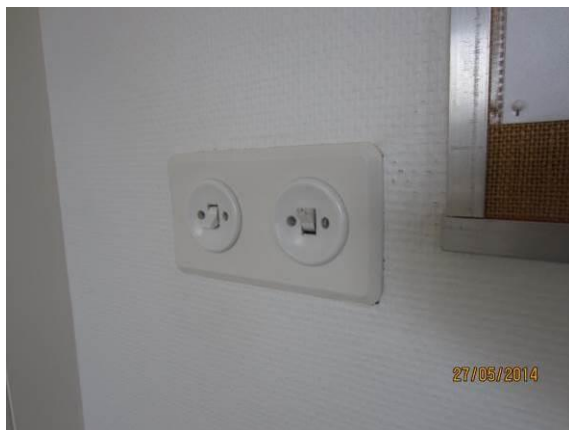
Kuva 62. Vanhoja käytössä olevia valokytkimiä 2.krsa aulassa.
