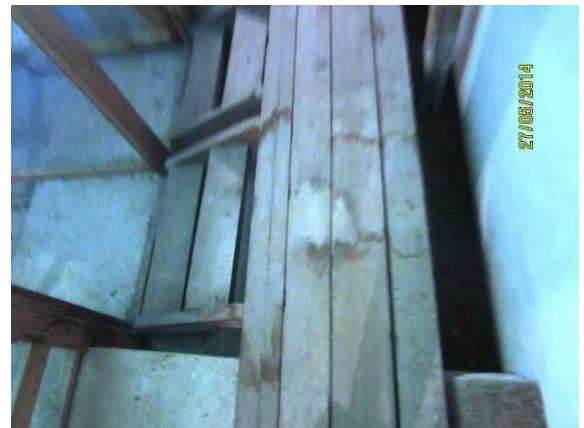
Kuva 16. Yleiskuva yläpohjasta, vuotojälkiä kulkusillan päällä.
