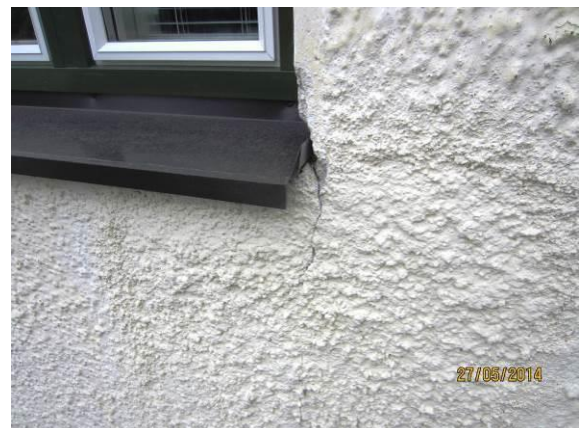
Kuva 20. Yleiskuva, ikkunapellin liitos puutteellinen. Rappausta ei ole jatkettu pellin päälle.
