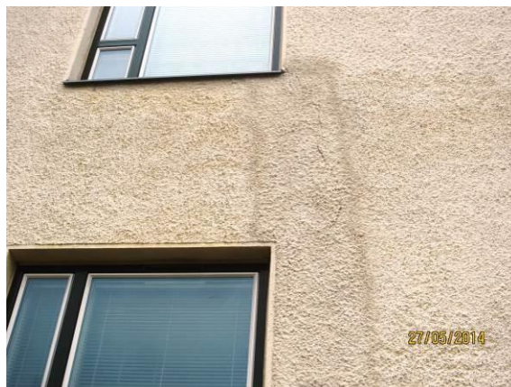
Kuva 22. Yleiskuva, halkeama on uusiutunut korjattulla osalla.
