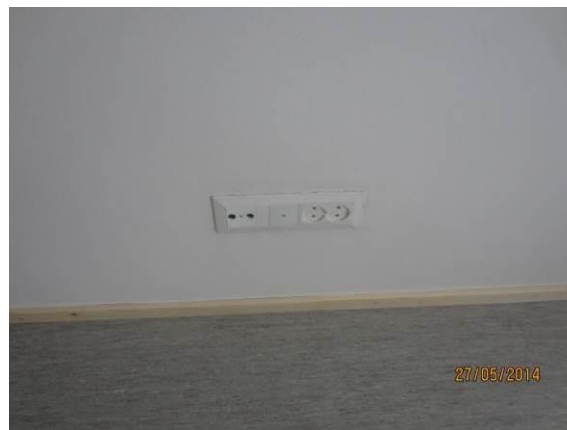
Kuva 63. Asuntolan 80-luvun asennuksia.
