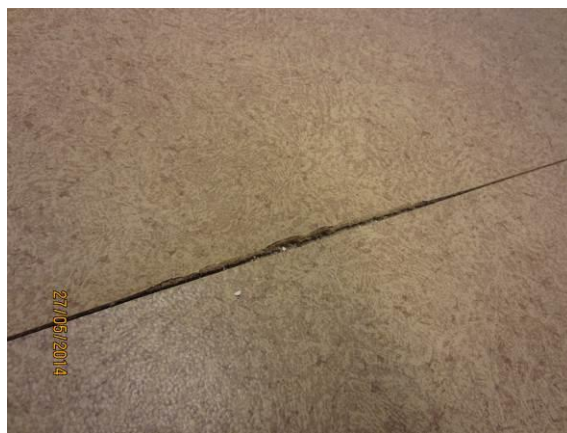
Kuva 48. Lattiamattojen saumat ovat paikoin rikki.
