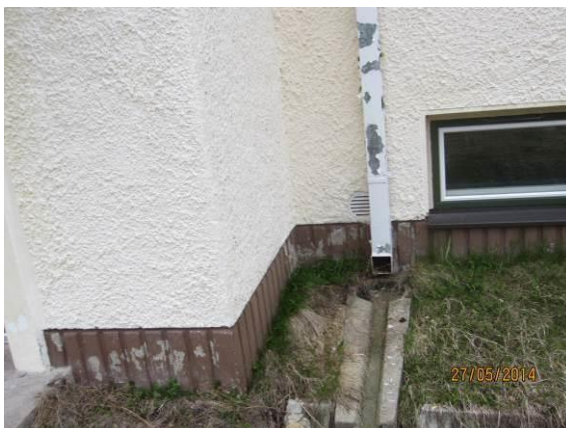
Kuva 19. Yleiskuva, kellarin perusmuurin maali on paikoin irronnut.
