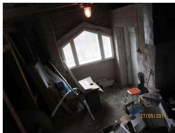
Kuva 70. Ullakon alkuperäisiä valaisimia.
