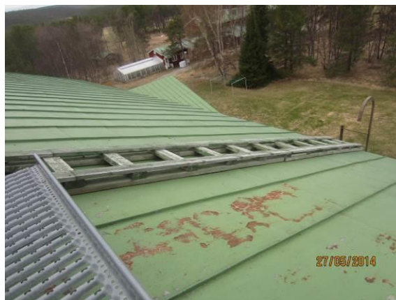
Kuva 30. Kate on paikoin ruostunut.
