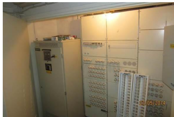
Kuva 57. PKB kellarin käytävällä sekä kondensaattoriparisto.
