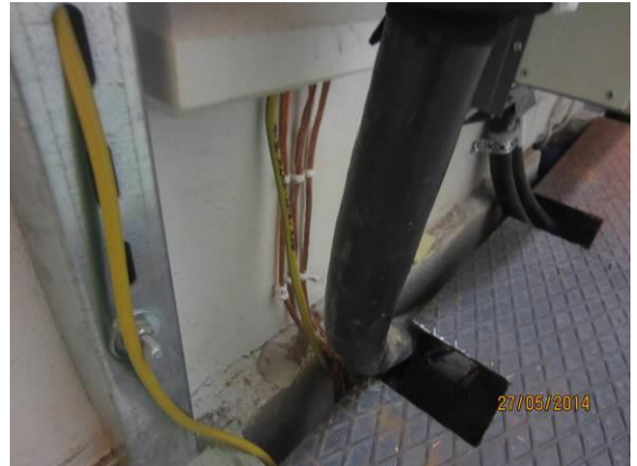
Kuva 55. Pääkeskuksen syöttökaapeli ja maadoitukset.
