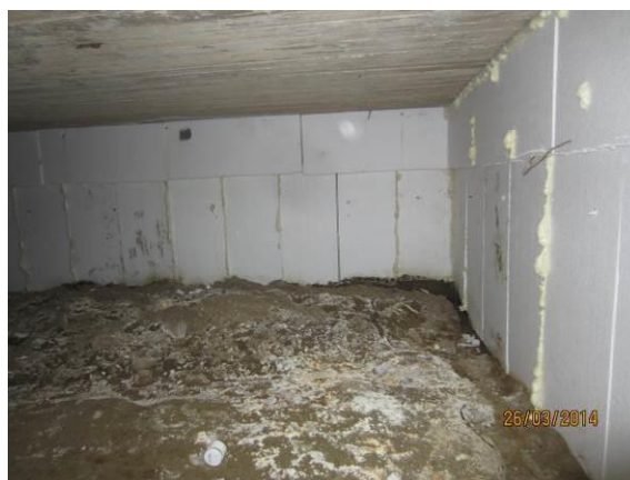
Kuva 13. Asuntola-osan alapohja. Hiekan pinnassa on näkyvää kasvustoa,
