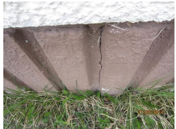
Kuva 18. Asuntola, kellarin perusmuurissa on halkeama.
