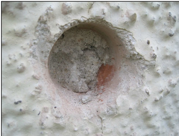
Kuva 14. Näyte on hajonnut rappauksen rajalta osittain, muuten kerrokset ovat kiinni (selvitysporaus 12).
