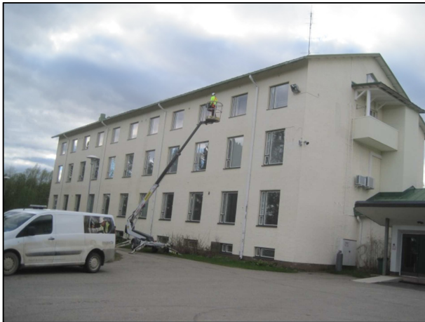
Kuva 2. Julkisivurappauksen maalipintojen yleisilme on pääosin kohtalaisen siisti.
