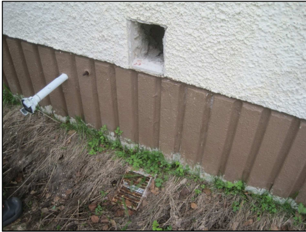
Kuva 8. Tuuletusritilä on irronnut.
