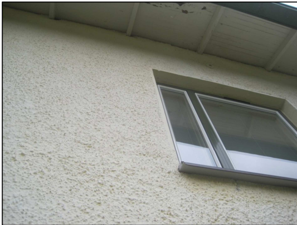
Kuva 10. Räystääsaluslaudoituksen alapinnan maali hilseilee paikoitellen.
