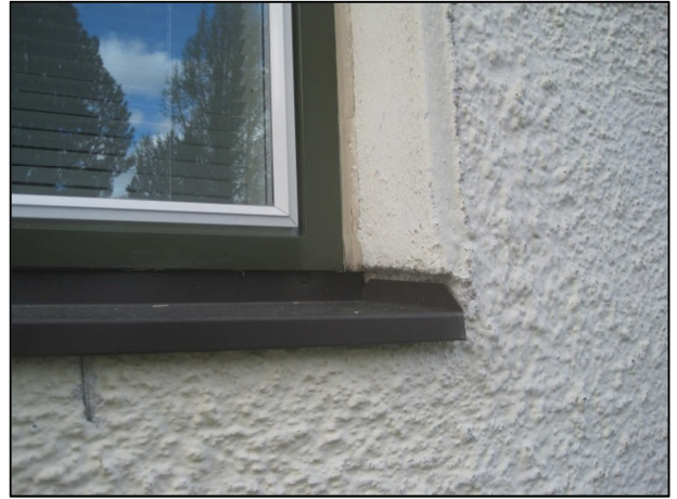
Kuva 9. Ikkunoiden vesipeltien kaltevuus on paikoin liian loiva.
