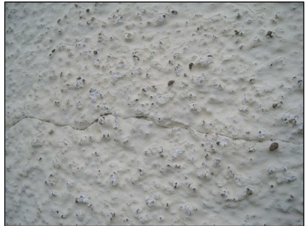
Kuva 3. Roiskerappauksen maalipinnoite on lievästi kulu- nut roiskeista, minkä lisäksi rappauksessa on eri asteisia halkeamia.
