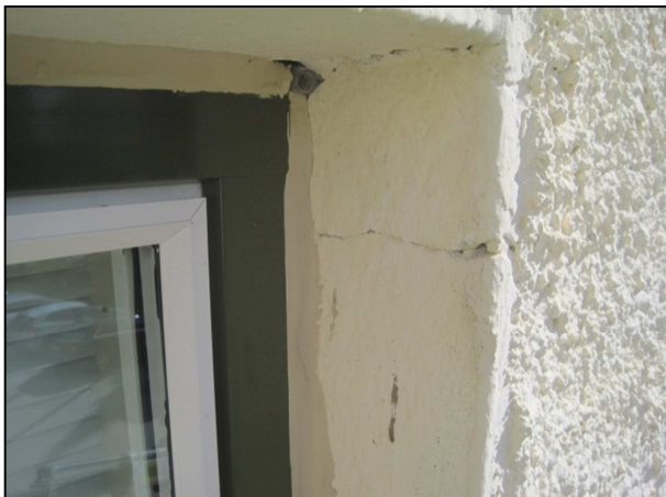
Kuva 4. Ikkunasmyygien sileäksi hierrettyssä rappaus- pinnassa on paikoitellen halkeamia.
