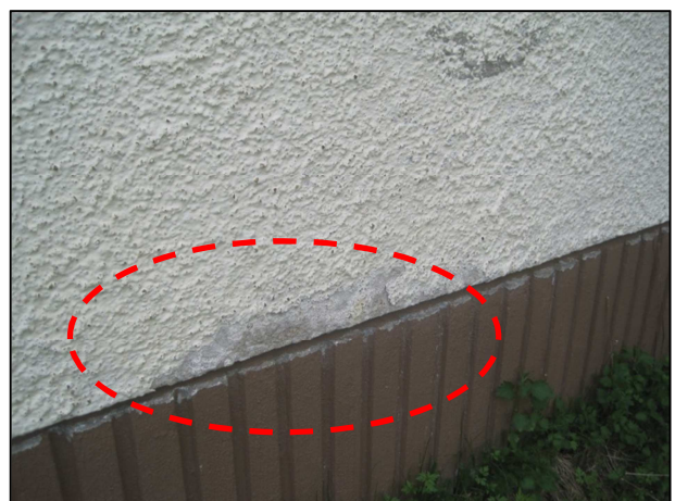
Kuva 7. Asuntola 2:n länsipäädyssä julkisivun alapinnas- sa oli havaittavissa rappauspinnan irtoamista pienellä alalla.
