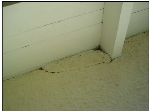
Kuva 5. Vesikatteen aluslaudoituksen ja julkisivun liittymäkohdissa on halkeamia, joista on lohjennut suuriakin kappaleita.
