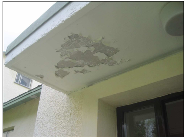
Kuva 11. Pääsisäänkäynnin alapuolen maalipinta irttaa alustastaan.
