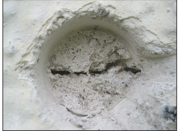
Kuva 13. Tiilimuuraus on haljennut, jonka seurauksena myös pintarappaus on halki. (selvitysporaus 7).
