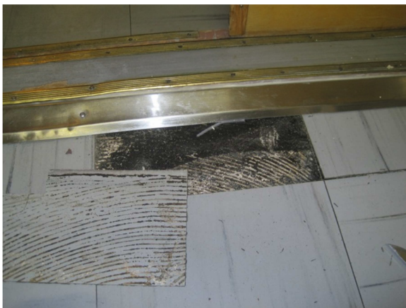
Kuva 1. Lattiassa oleva vinyylilaatta ja kiinnitysliima sisältävät asbestia.
