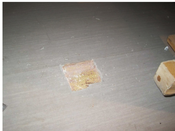
Kuva 2. Asuntola 2:n 3. krs:n huoneiston lattian linoleum-matto, liima ja tasoite sisältävät asbestia.
